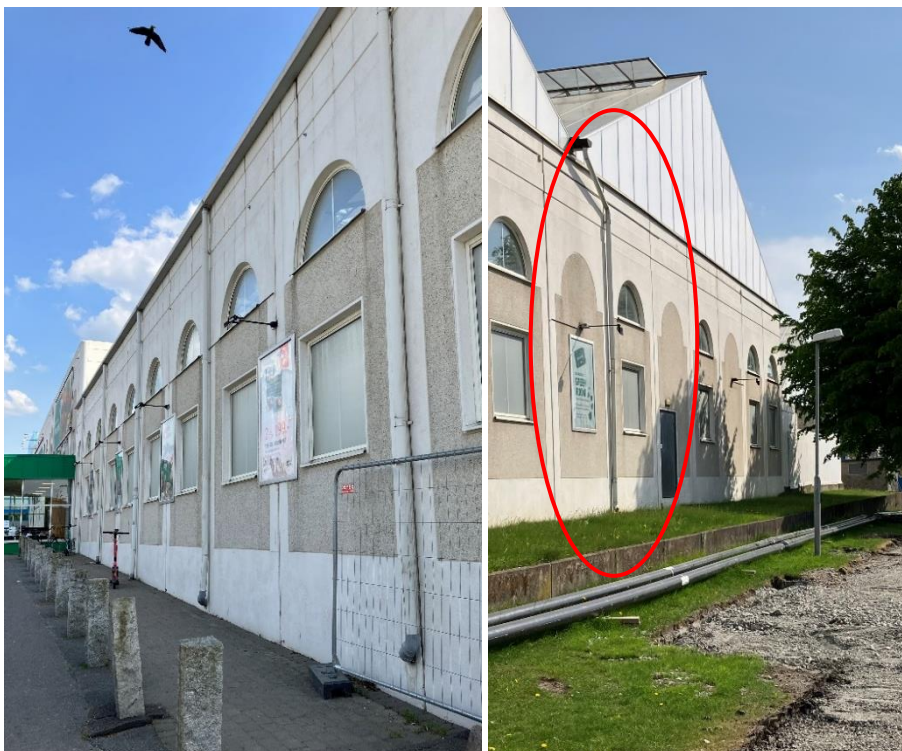
Figur 3. Utvändiga stuprör på Blomsterlandets norra (vänster) och västra sida (höger). Stuprör inringat i rött leder ut takvatten på gräsytan.
